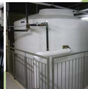
Réservoir d'accumulation de chaleur
